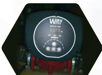
ИТП, г. Екатеринбург, ул. Курчатова, 27, к.2
