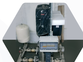
Установка ВНС, г. Новосибирск
