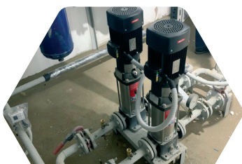
Индивидуальный тепловой пункт г. Уфа,
