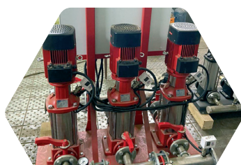
ЖК, установки ВНС и ПНС г. Владикавказ
